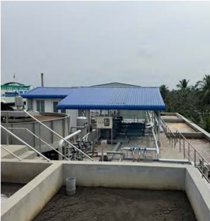
Hệ thống xử lý nước thải đạt loại A, theo QCVN 11-MT-2015 tại Nhà máy chế biến cá tra – Aquatex Bentre
